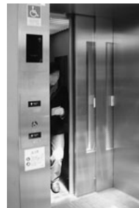
① 柿生駅に設置されたエレベーター
