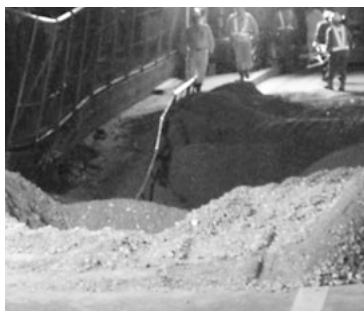
陥没事故の現場(おおば議員撮影)
